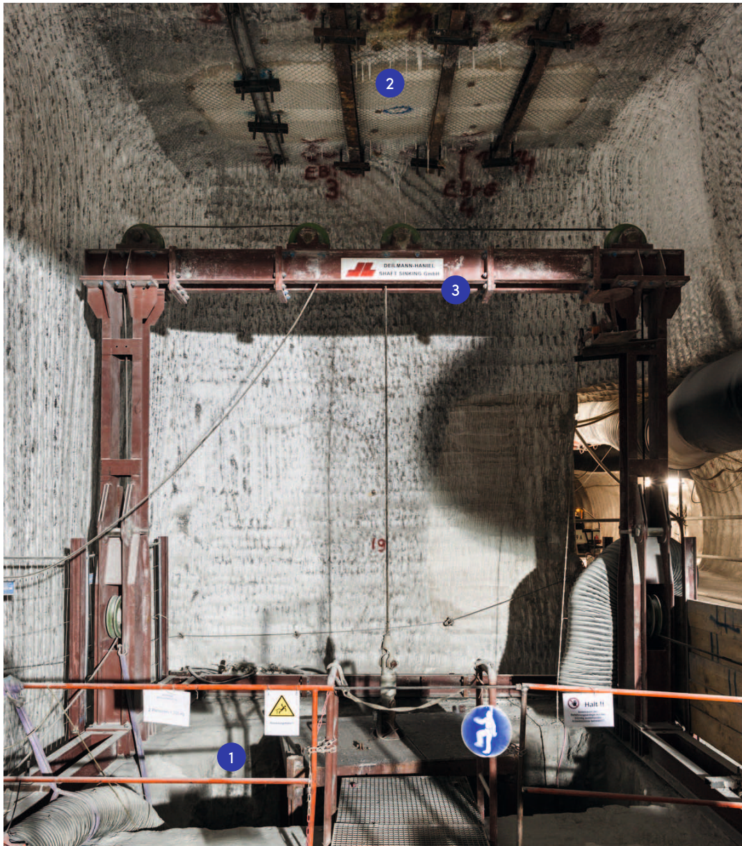
Befahrungsanlage für den Blindschacht 1 in 725 Metern Tiefe
