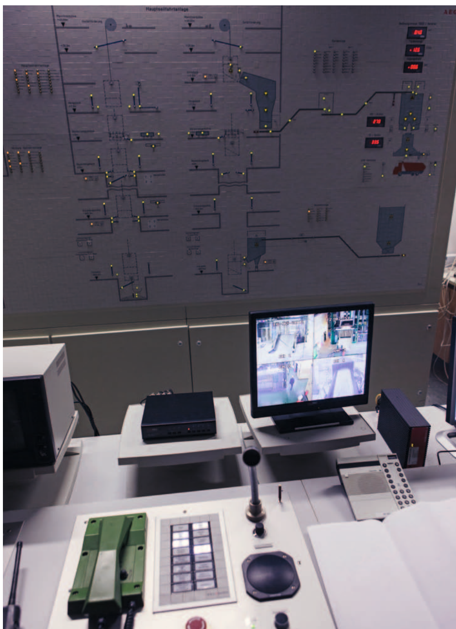
Schaltzentrale im Bergwerk Gorleben
